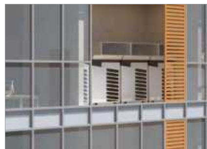
La unidad exterior queda oculta en el interior del edificio sin afectar a la estética
