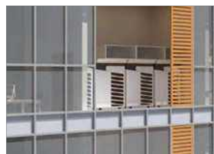
La unidad exterior está oculta dentro del edificio sin afectar a la imagen general del edificio
